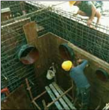
图1 穿墙管直接预埋在墙体内
